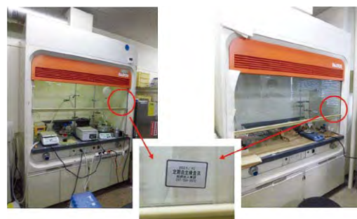
局所排気装置の定期自主検査
